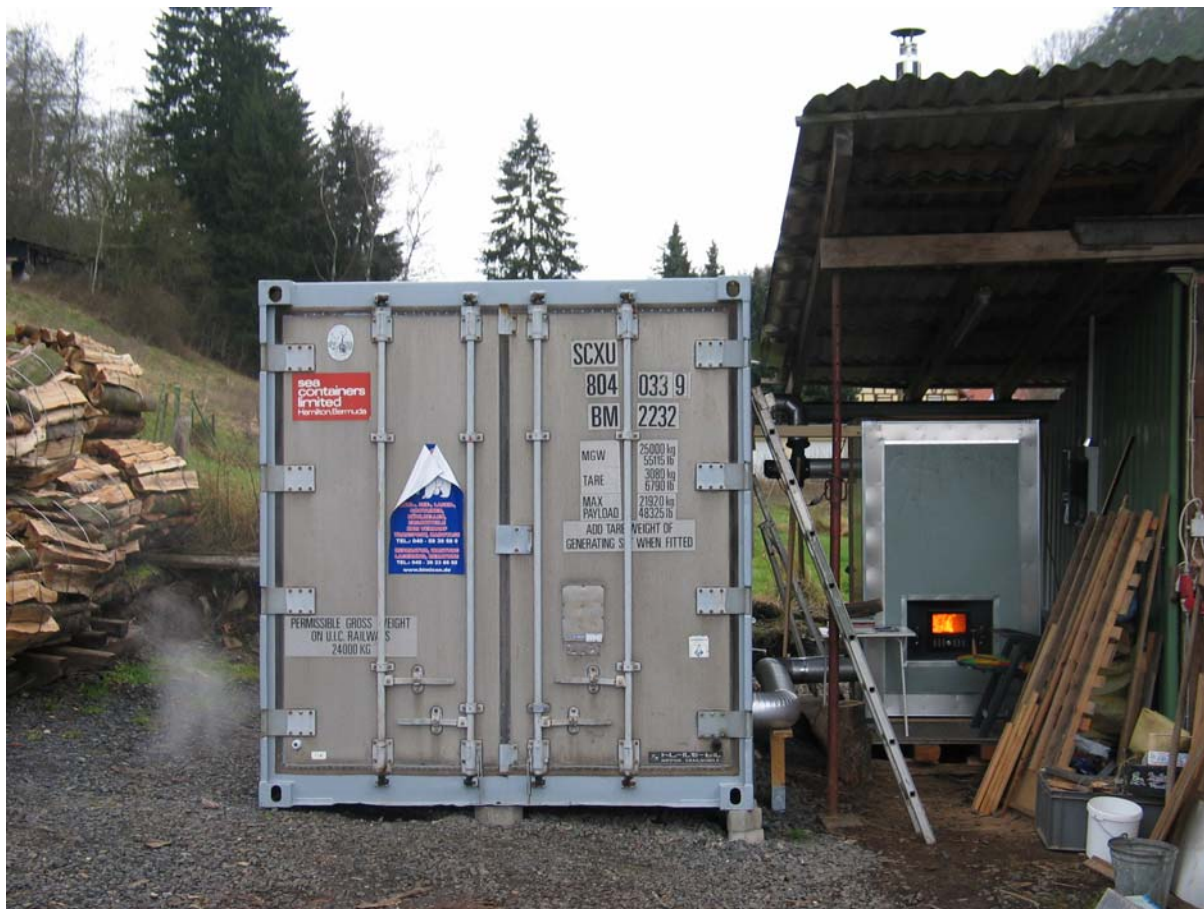
Abb.: Scheitholz-Kontainer Trocknung mit Umluft und Warmluftheizung (rechts) und Abluft (links)
